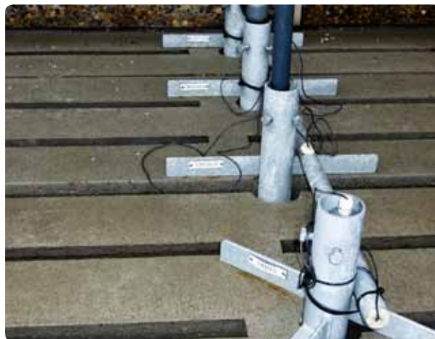
Billede 5. Niveaufølere til pumpen som måler gylleniveau i kanalen.
