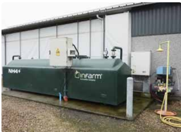
Billede 1. Gylleforsuringsanlæg fra Infarm der kan regulere pH i gødningen
