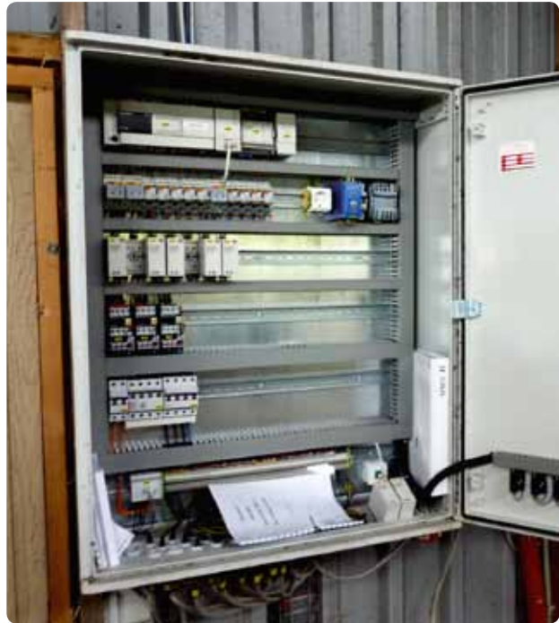
Billede 7. Installationer er godt beskyttet i skab
